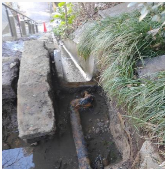
鋼管の破損による漏水(令和6年1月 寿)
