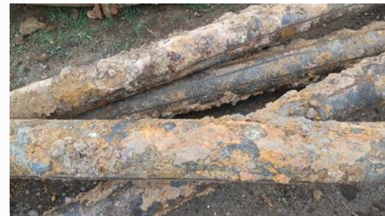
老朽化により腐食した鑄鉄管
