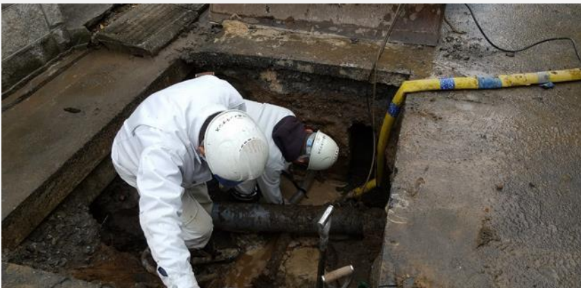
塩化ビニル管の破損による漏水(令和6年1月 並木)
