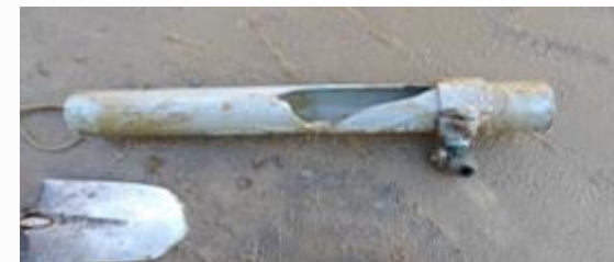
老朽化により破損した塩化ビニル管
