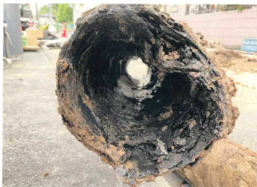
図 3.4-1 老朽化した管渠(Zパイプ)
