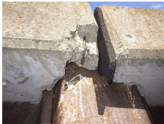
図 3.4-2 老朽化した雨水排水路
