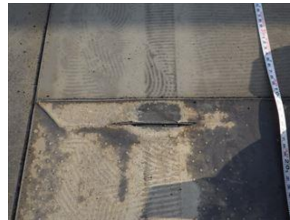
図 2.10 防水シート傷と周囲の汚れ
