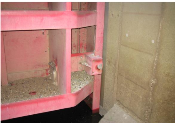
図 2.8 吐出樋門 (鳥糞堆積)
