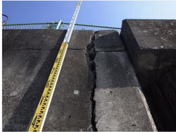
図 2.14 上流側護岸工南端の剥離
