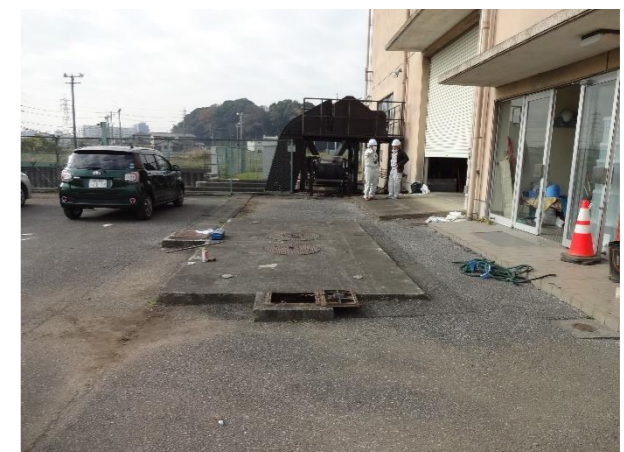
図 2.13 地下重油槽周辺地盤の沈下
