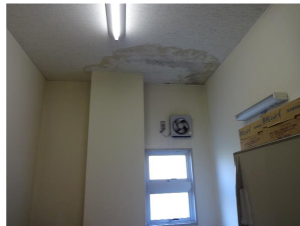
図 2.12 雨水進入状況
